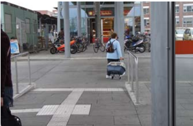
Der direkte Weg zum Gleis 1 ist noch durch die Container der Baustelle blockiert.
