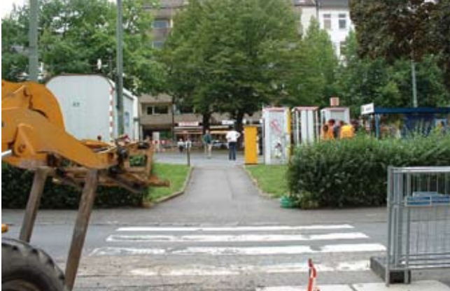
Vor dem Ausbau. Im Bereich der Querungsstelle war der Bord der Mittelinsel praktisch auf 0 cm abgesenkt.
