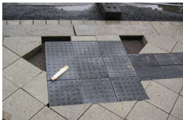
Wegen des nachträglichen Einbaus des Leitsystems mussten viele Platten geschnitten werden. Das Fugenbild wird beeinträchtigt.
